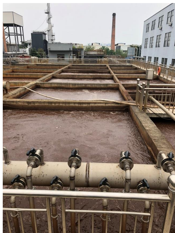
废水处理设施
