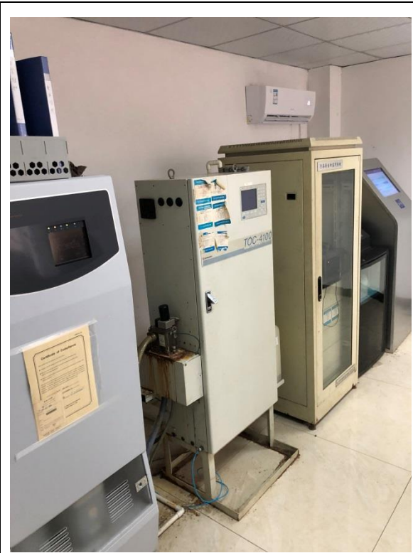
污水站在线中控系统
